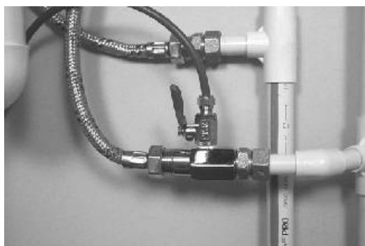
Zdj. 1. Sposób podłączenia zestawu filtrów do instalacji wodociągowej.
